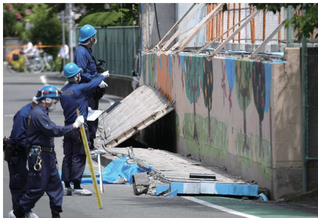
倒壊した高槻市立寿栄小のブロック塀
