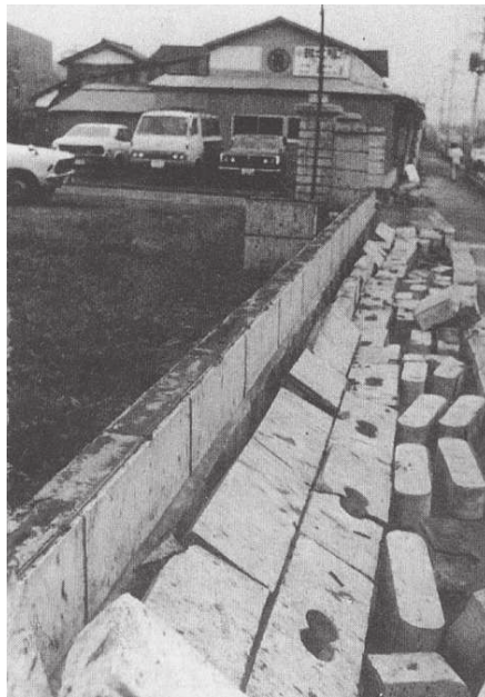
宮城沖地震で倒壊したブロック塀
