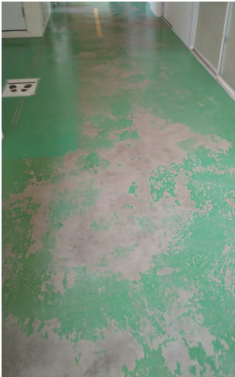
樹脂が剥がれてしまっている廊下（緑ヶ丘中）
