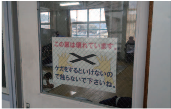
壊れて開かないドア（緑ヶ丘中）
