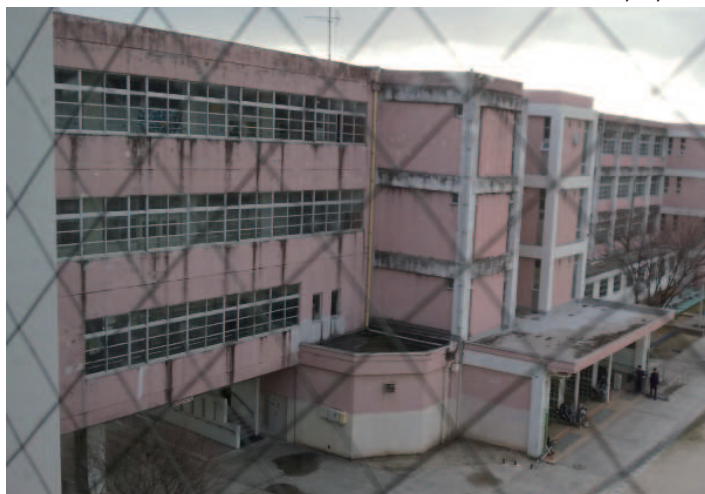
外壁はボロボロ（緑ヶ丘中）
