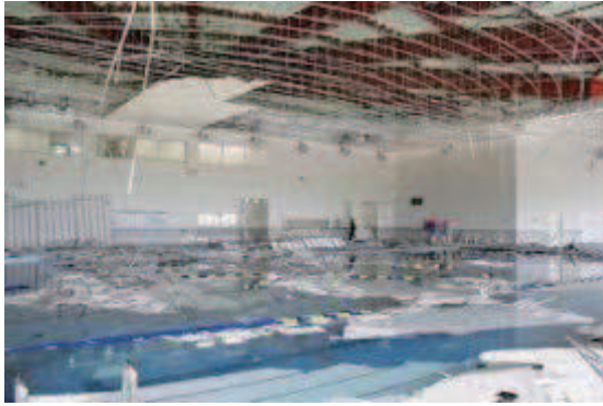
天井が剥がれ落ちたスパパーク松森（仙台市）
